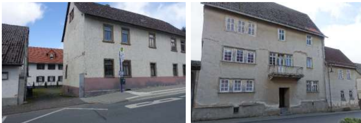
Abb. 48: links: leerstehende und unter Denkmalschutz stehende „Alte Kaserne“ mit sehr hohem Modernisierungsbedarf in der Lindenstraße in Pfaffenwiesbach; rechts: ebenfalls leerstehendes modernisierungsbedürftiges Kulturdenkmal „Ehemaliger Nassau-Oranische Amtshof“ in der Hauptstraße
